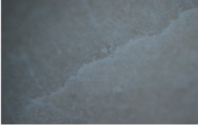
Şekil 2. Macun mikro silisin çatlak içindeki yerleşimi
